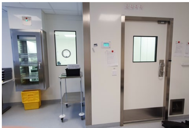
Inslussning av personal sker genom tvåstegsslussning, till höger i bilden. Beredningar slussas ut i specialbyggda ventilerade genomräknings-skåp, till vänster i bilden.
